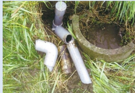
盗難被害に遭った給水用バルブ
