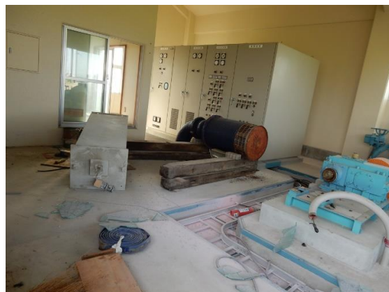
荒らされた施設内
