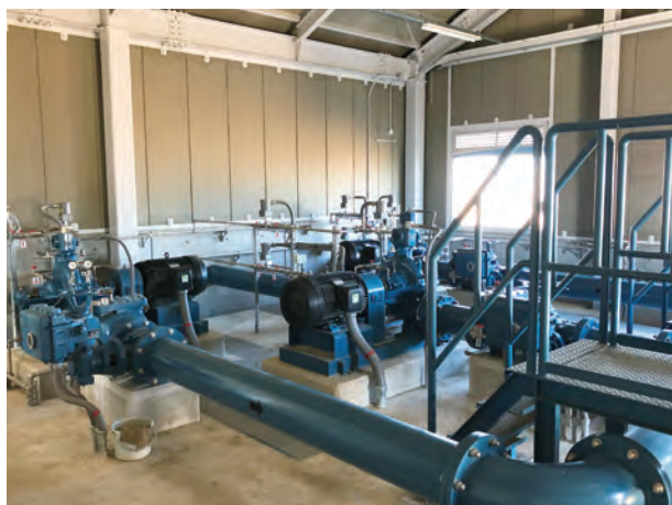
望地機場ポンプ
