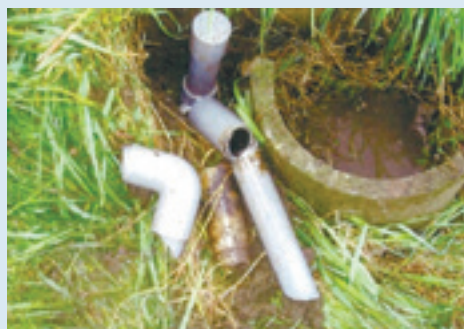
盗難被害に遭った給水用バルブ
