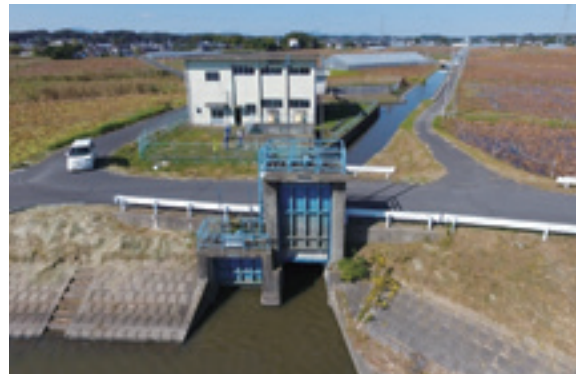
玉里排水機場
