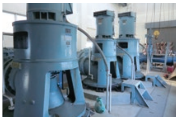
用排水機場ポンプ
