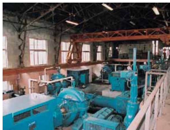
第一機場内ポンプ設備
